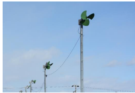
図 5. 園内に設置された防霜ファン
